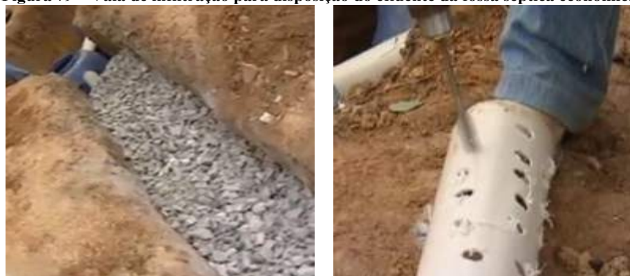
Figura 79 – Vala de infiltração para disposição do efluente da fossa séptica econômica
