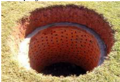
Figura 72 – Tipologia de sumidouro: sumidouro de tijolo
