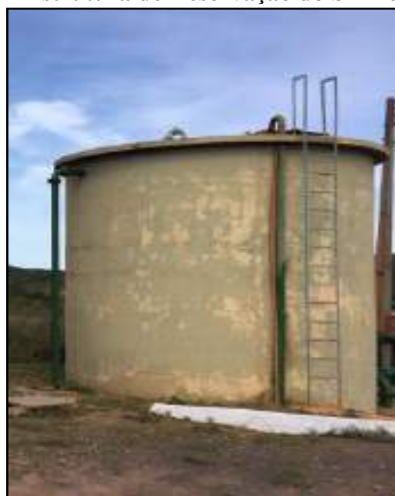
Figura 17 – Estrutura de Reservação do SAA da Embasa
