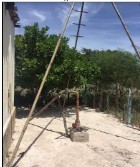
Figura 20 – Poço de abastecimento de água da localidade de Gameleira do Assuruá
