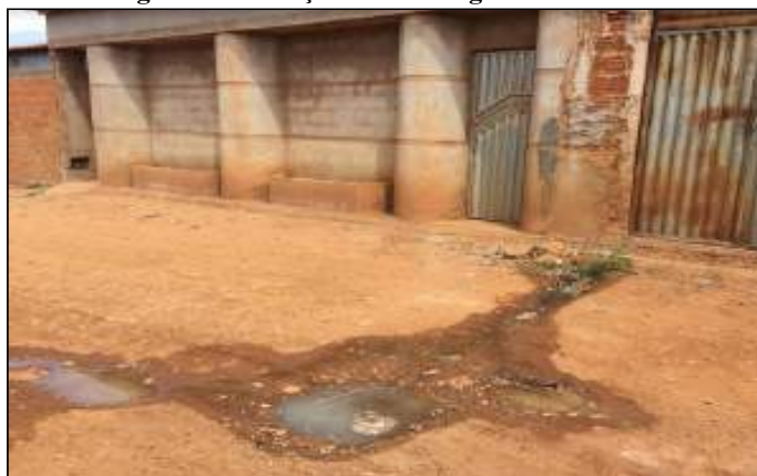
Figura 41 – Lançamento de esgoto a céu aberto na sede de Gentio do Ouro/BA
